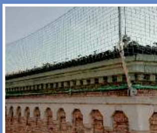
PARAPETTI IN RETE
