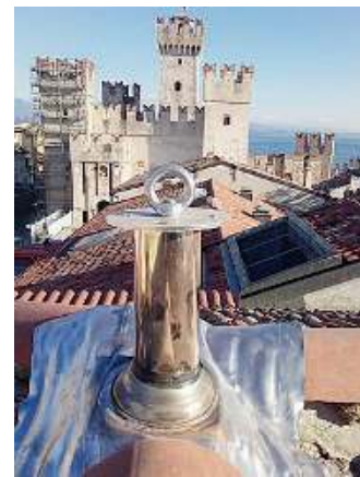
La realizzazione. Una installazione realizzata da LineaSikura
